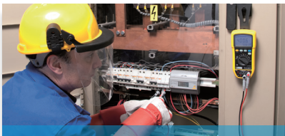
Messung bei Niederspannung
