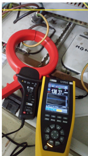
Messung mit Leckstromzange und Fehleraufzeichnung.
