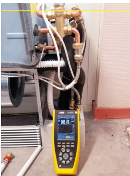
Messung an Heizungs- und Klimaanlage: Strom, Spannung, Temperatur.
